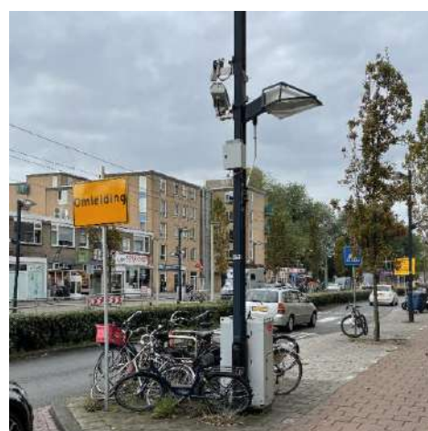
Meetpost rijbaan richting West
